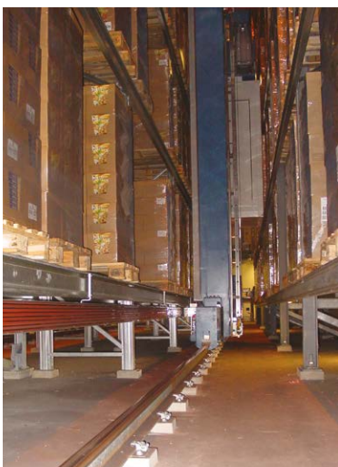
Einspeisung und Steuerung eines RGB's in einem Tiefkühlager
