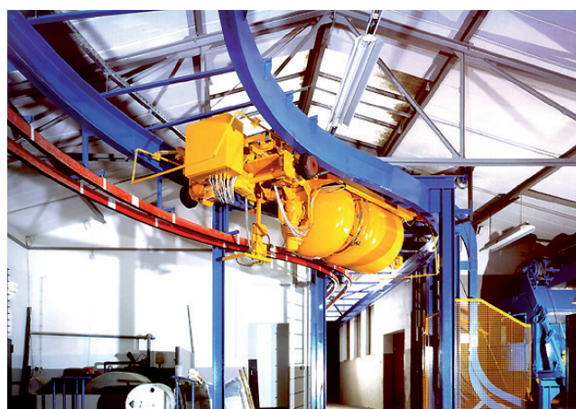
Versorgung und Steuerung von Betonkübelanlagen.
