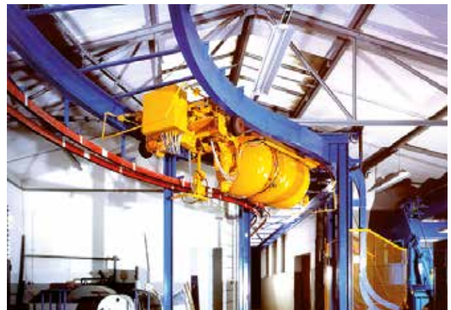
Voeding en besturing van een betonkubel
