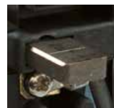
Visuele inspectie van de koolborstels is erg eenvoudig door de aangebrachte markering.
