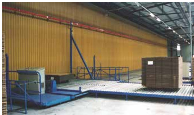
Gaine de rail type RN7 pour l'alimentation et la commande d'un chariot de traverse dans une fabrique de cartons.
