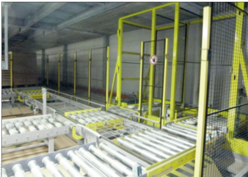
Ook de transferwagens in de pickingzone worden gevoerd door middel van de Productor stroomrail van AKAPP.
